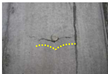
沈みひび割れ
