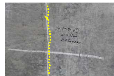
温度応力ひび割れ
