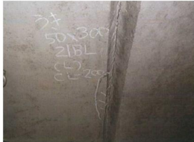
写真 6-16 天端部に発生したうき (横 50mm×縦 300mm)
