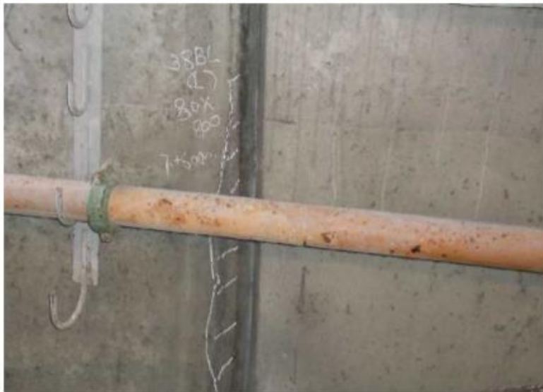
写真 6-15 側壁部に発生したうき (横 80mm×縦 800mm)
