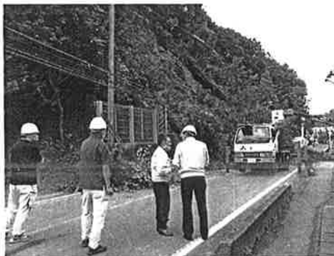
萩市椿東（中の倉）土砂崩れ災害発生
