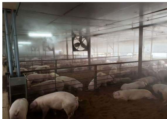
自動細霧装置
