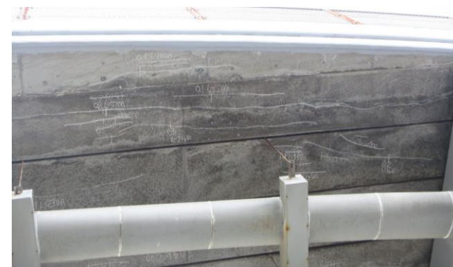
第3スパン損傷写真
