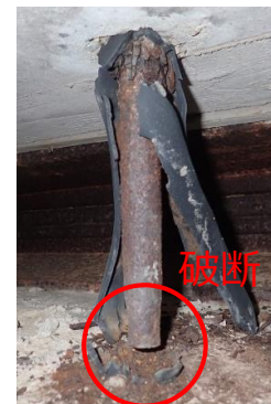
写真 鉛直PC鋼材の破断 （青海大橋（下り線））
