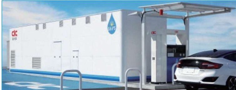
再生可能エネルギー利用水素ステーション
