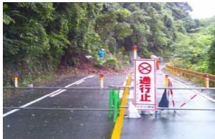
▲長門市徳山 【H25.7 被災状況】
