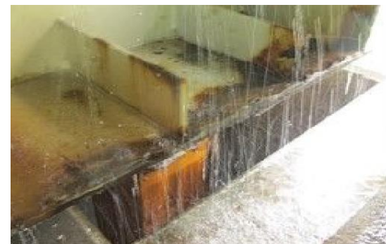
P7橋脚：伸縮装置からの漏水
