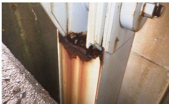
P2支承：支承の腐食
