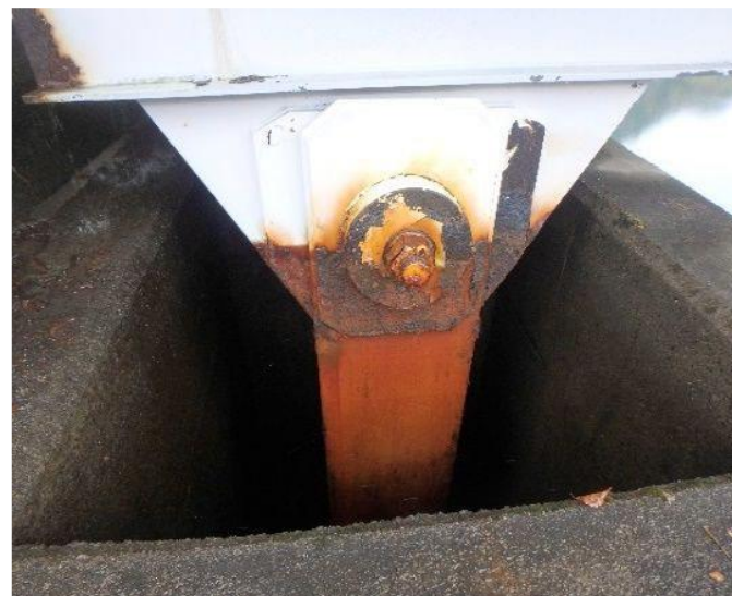
P7橋脚 : 支承の腐食
