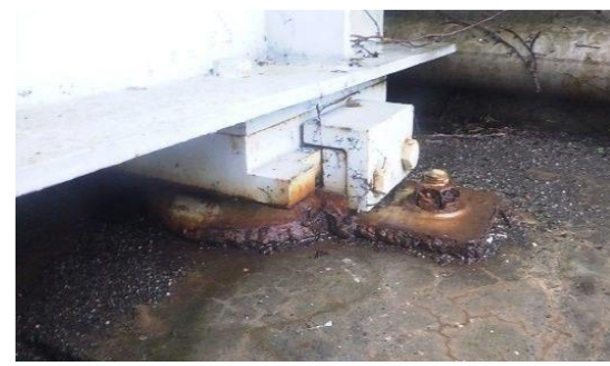
P8支承：支承の腐食
