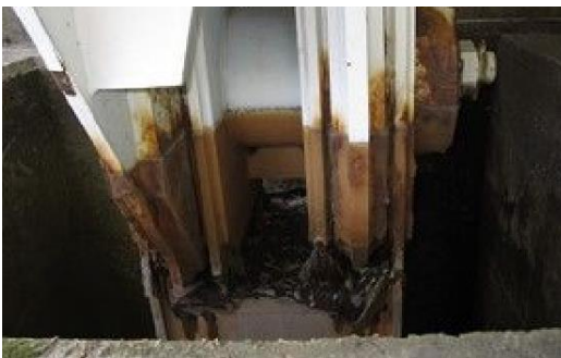
P7橋脚：橋座部箱抜き部の滞水
