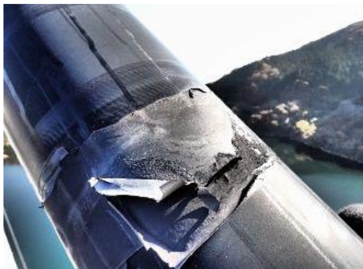
斜材ケーブル (KR4-5) : 補修材の損傷
