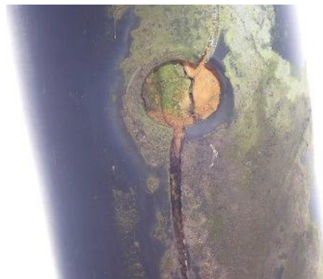
斜材ケーブル (KR4-4) : グラウトのひびわれ
