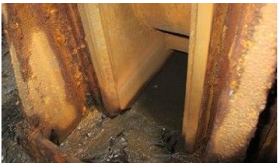
P7橋脚：鋼材の腐食
