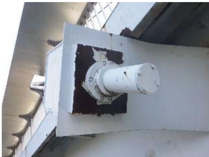
斜材ケーブル (KR4-5) : 定着部の腐食
