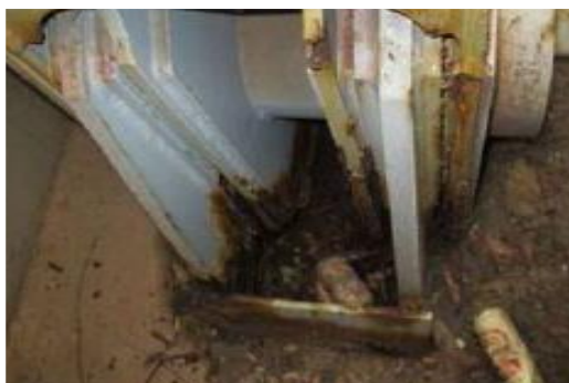
P2支承：支承の腐食
