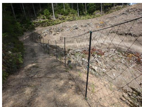
R4 森林環境保全整備事業 [鳥獣害防止施設等整備] シカ防護柵設置事業地 (美祢市)
