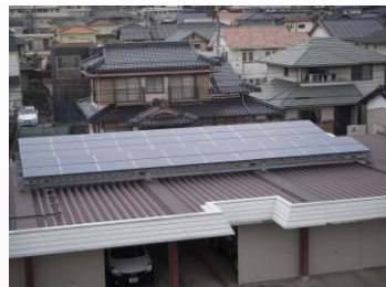
太陽光発電設備
