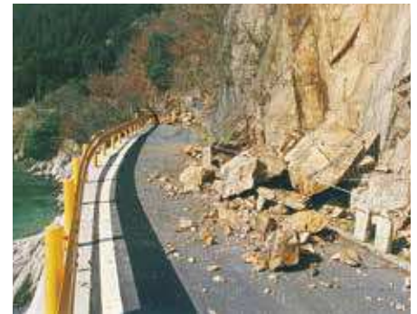
地震による被害
