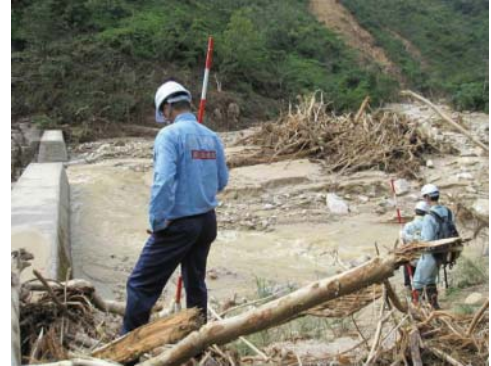
緊急災害対策派遣隊による被災状況の調査
