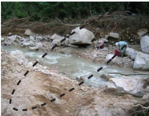
土石流発生を検知するセンサー(点線部分)の設置
