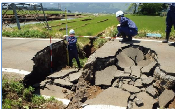
（TEC-FORCE：国道被災状況調査）
