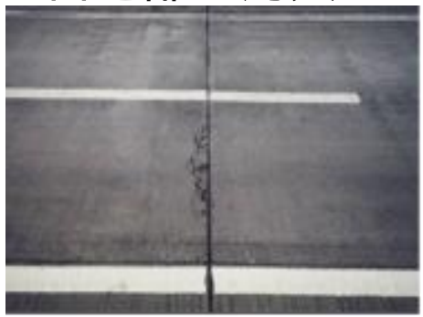
目地部の角欠け
