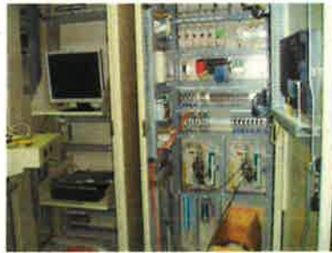
PC・PLC制御システム
