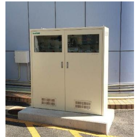
圧縮水素ボンベ保管庫(48ℓ×6本)
