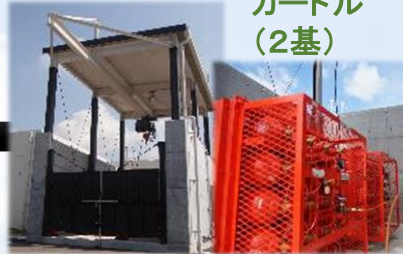
カードル保管庫 (新設)
