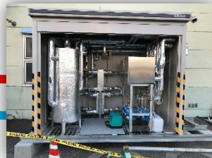
熱交換器・ヒートポンプ等
