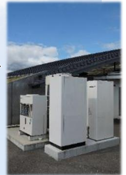
3.5kW級FC・ 給湯設備(新設)
