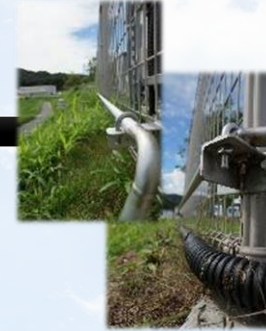
水素配管 電気配線
