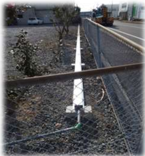
公道水素配管
