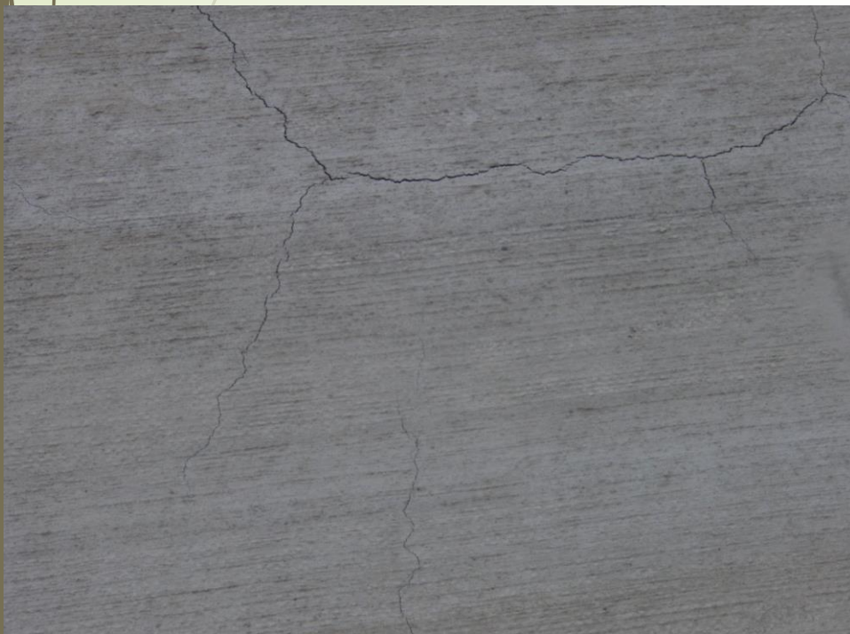
乾燥ひび割れの例
