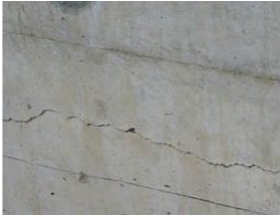
ボックスカルバート 側面の沈降ひび割れ
