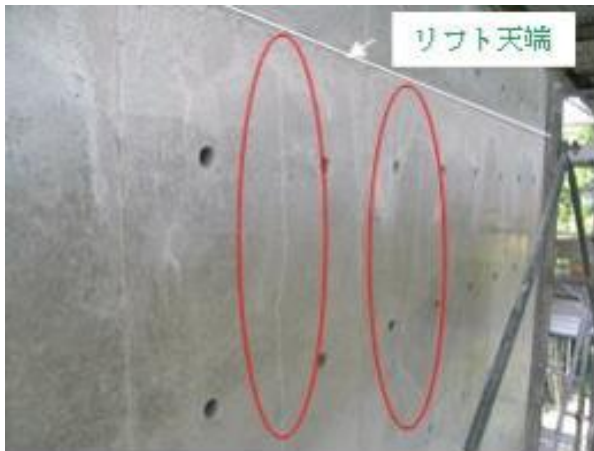
温度ひび割れ
