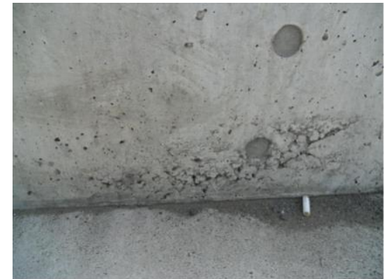
擁壁表面の豆板
