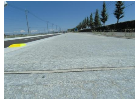
中央分離帯のプラス チックひび割れ
