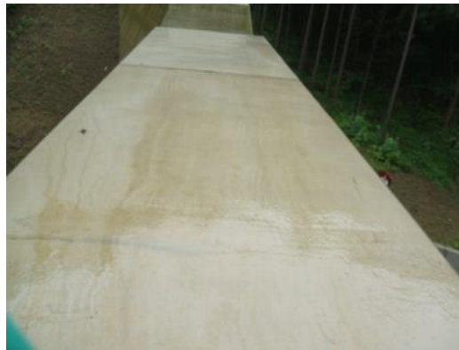
乾燥収縮ひび割れ
