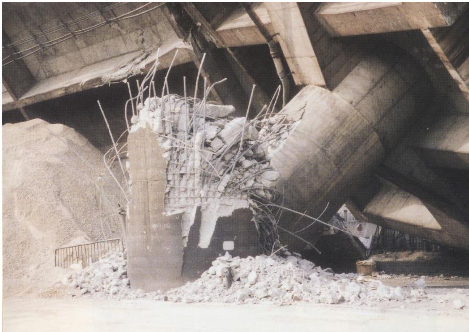
写真 阪神大震災のときにせん断破壊した鉄筋コンクリート柱
