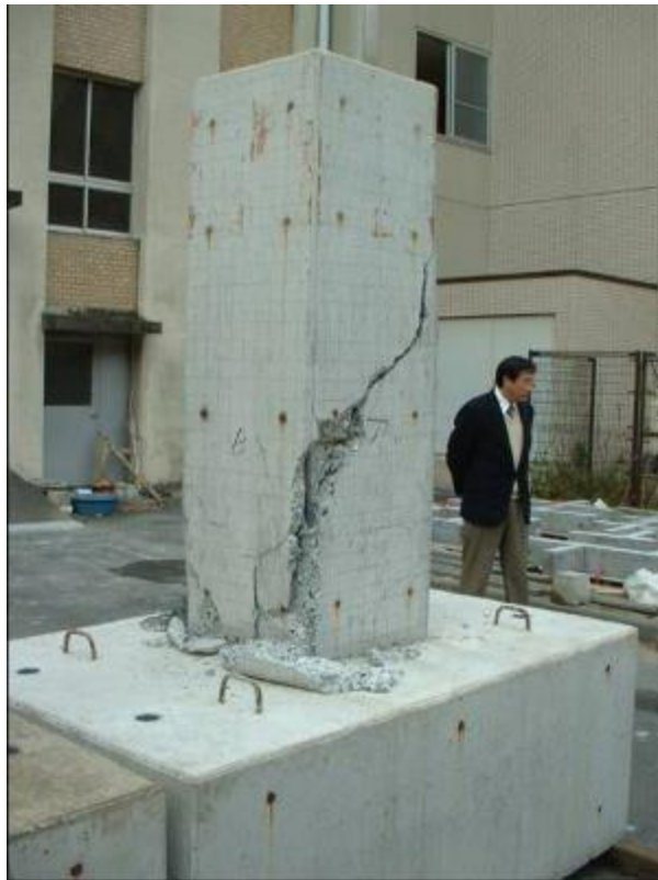
写真 せん断破壊した柱
