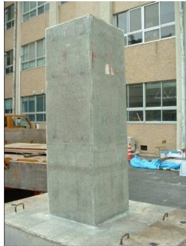
写真 曲げ降伏している柱
