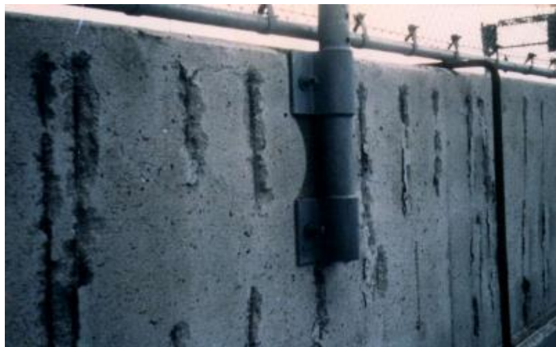
かぶり不足で鉄筋が腐食した高欄
