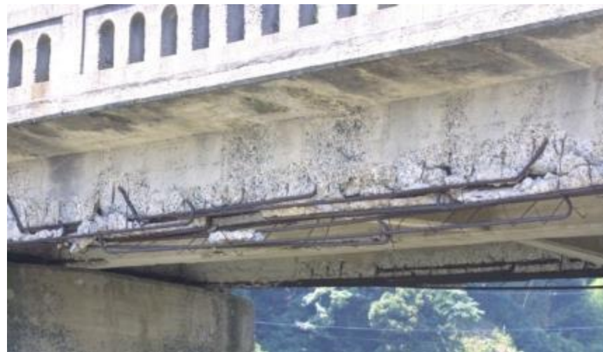
かぶり不足で鉄筋が腐食した橋梁
