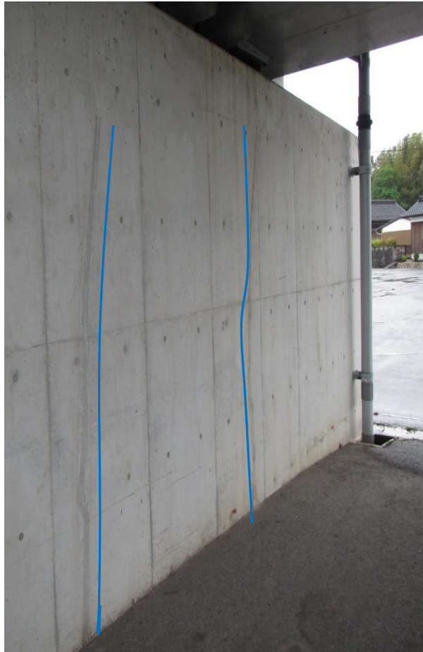
外部拘束による温度ひび割れ
