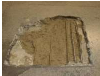
RC床版の土砂化（ASR, 凍害, 疲労の複合劣化）
