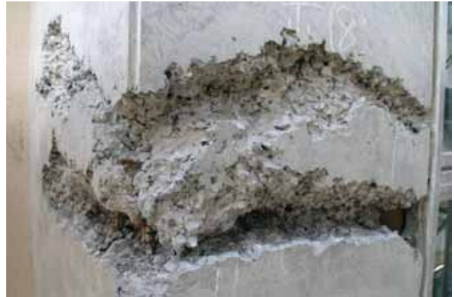
写真2 竣工後1年で全面的な補修となった屋内運動場では見つかった打設不良によるジャンカ/施工した業者は6ヶ月の指名停止、市の担当職員にも減俸処分が科された
