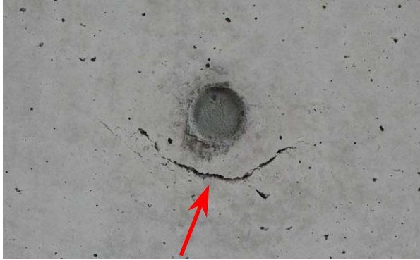
【セパレータのコーン跡下方】
