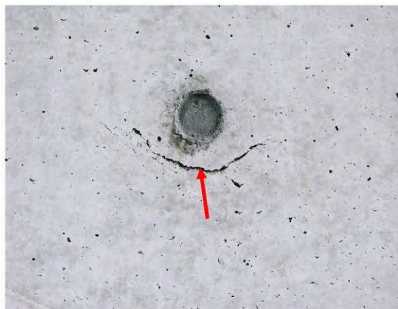
図 4.5.2 沈みひび割れ
