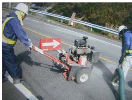
クラックカットの状況
