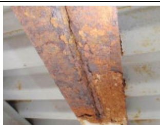
主桁、床版：腐食
