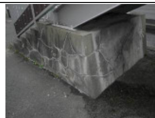
橋台：ひびわれ
