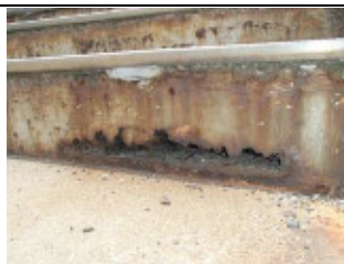
蹴上げ：腐食、欠損
