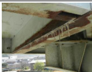
主桁、横桁：腐食、遊離石灰
