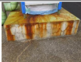
根巻きコンクリート：腐食、ひびわれ
