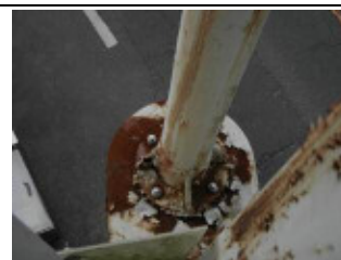
照明施設：腐食
