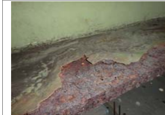
② 部材 上部構造 横桁 判定区分 II
