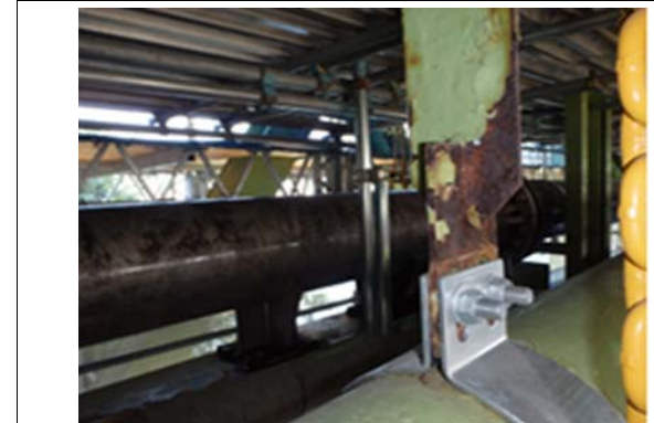
⑥ 部材 その他(排水施設) 判定区分 III
