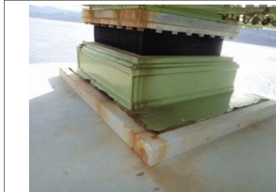
⑤ 部材 支承部 判定区分 I
