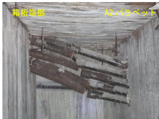
図 4.43 西側添架物の破損状況
