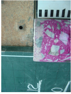
写真3. 中性化深さ測定結果状況 A-B-C点付近写真
