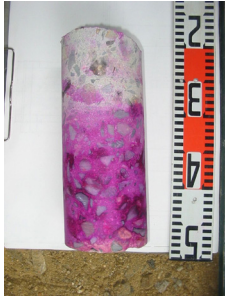
写真3 中性化深さ測定結果状況 F-G点付近写真
