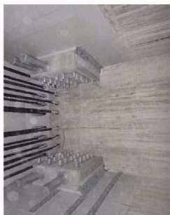
⑦P2部壁面状況
