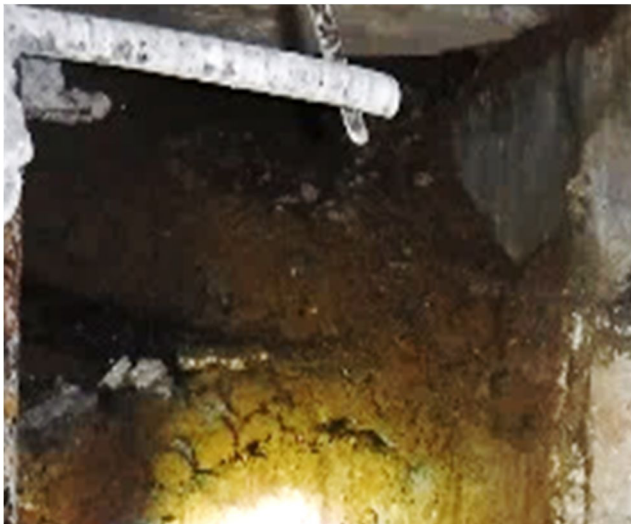
写真 1 桁裏堆積土砂
