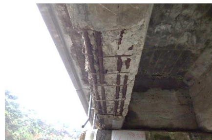
橋梁の老朽化の状況
