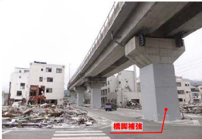
国道45号 (観測震度:震度6弱)
