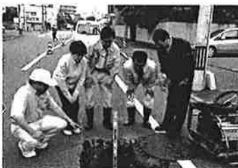
◀開削作業で空洞発見(宇部市寿町)
