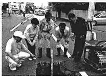
◀開削作業で空洞発見(宇部市寿町)
