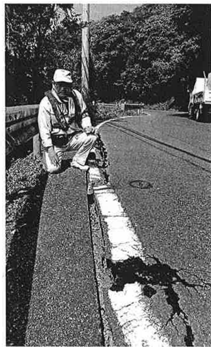
通行止めになった県道を調査
