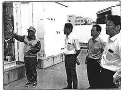
水素供給施設
