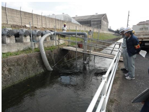
非常用代替水路での給水訓練
