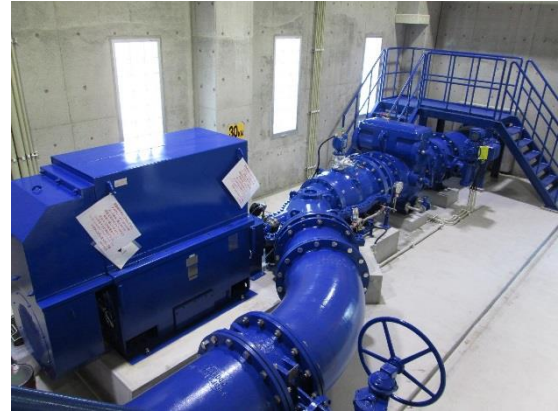
宇部丸山ダム送水ポンプ場
