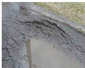
(陥没した歩道)
