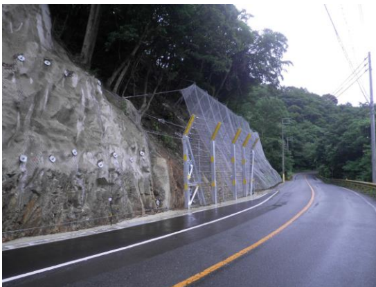
【のり面对策】 県道萩篠生線（萩市大字椿東）
