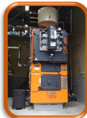
【木質資源ボイラー】
