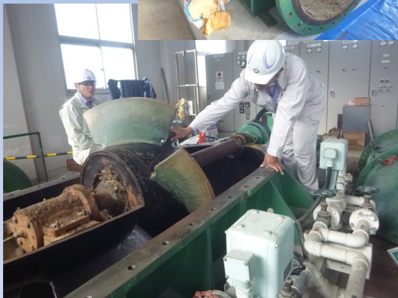
築30年の排水ポンプを点検
