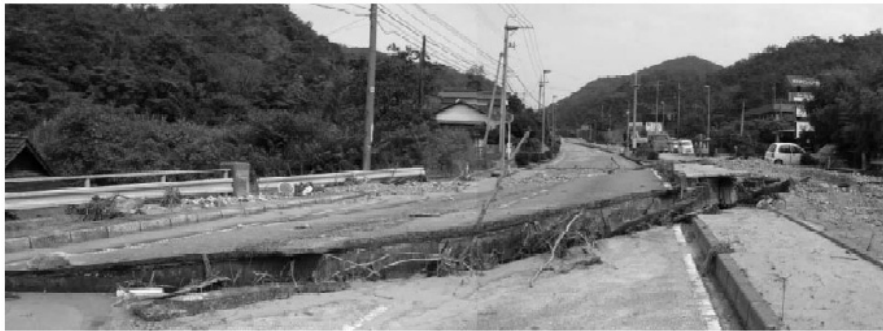
国道262号防府市勝坂の上勝坂橋被災状況
