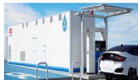
再生可能エネルギー利用水素ステーション
